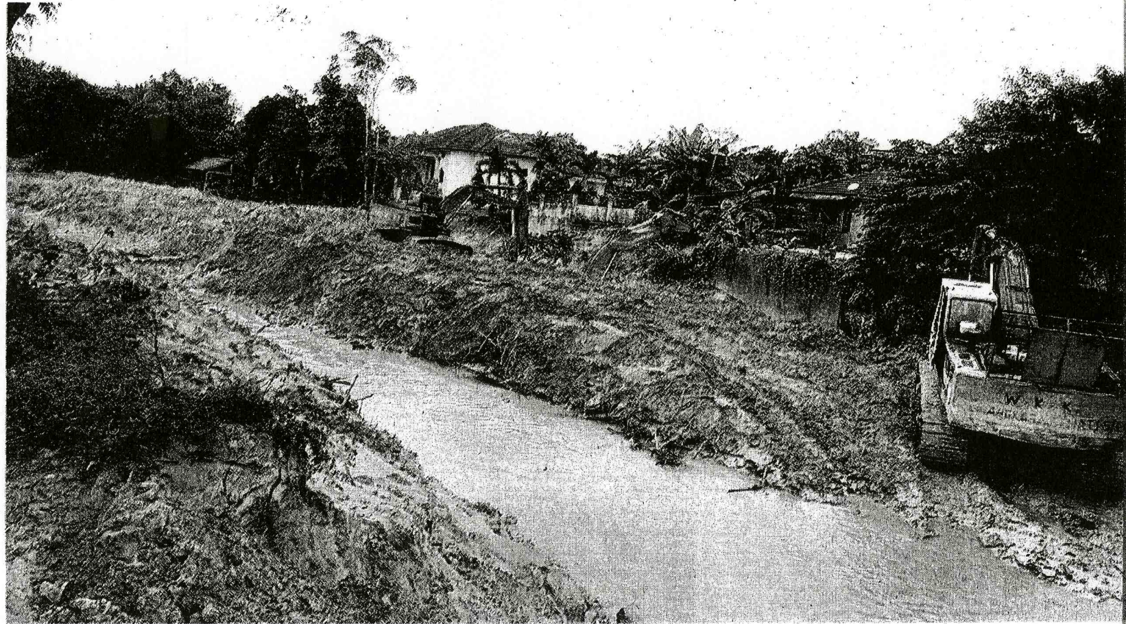
JENTERA pengorek menjalankan kerja-kerja melebar dan mendalamkan Sungai Pemula, Kampung Melayu Subang, Shah Alam, semalam. – Gambar RASHID MAHFOF
