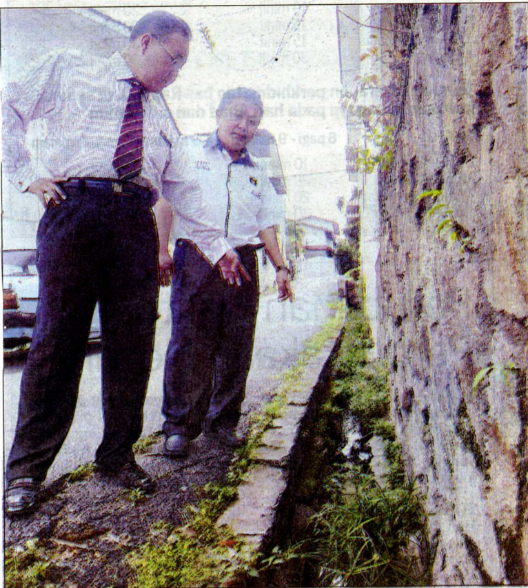
SIM IK (kanan) menunjukkan longkang yang rosak di Jalan Durian 4, Taman Cheras, Kuala Lumpur.
