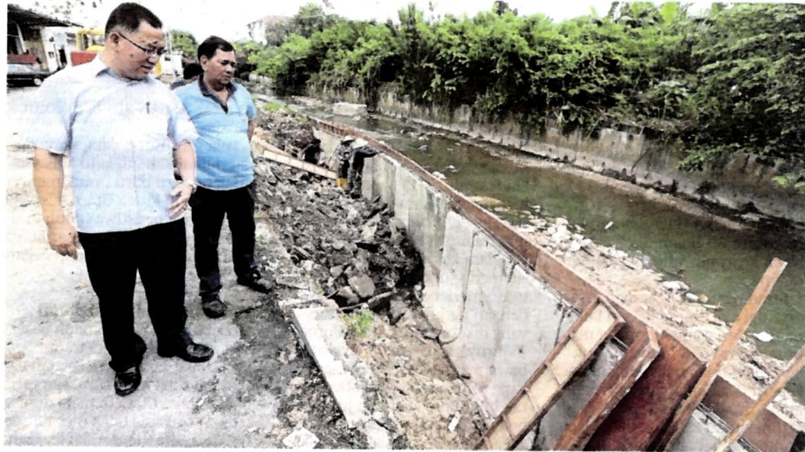
Kok Wee (kiri) meninjau tebing sungai yang runtuh.
