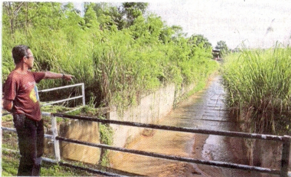
RAZALI menunjukkan longkang di lereng bukit yang mengalir ke kawasan tadahan air menyebabkan banjir lumpur di Taman Semenyih Permata.
