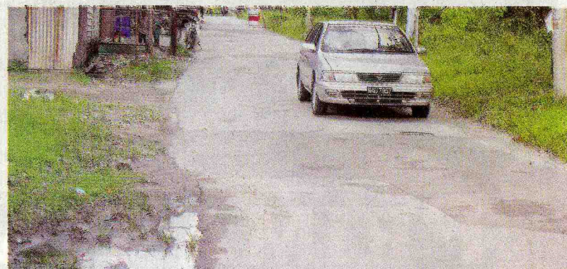
PERLU DIBAIKI: Jalan di Kampung Bukit Tembok rosak dan tidak rata.
