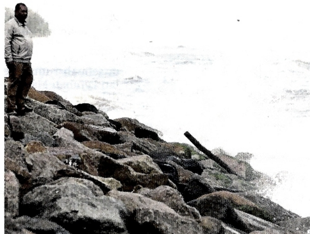
Longgokan batu disediakan pihak berwajib tidak mampu menahan pukulan ombak daripada membadai rumah penduduk.
