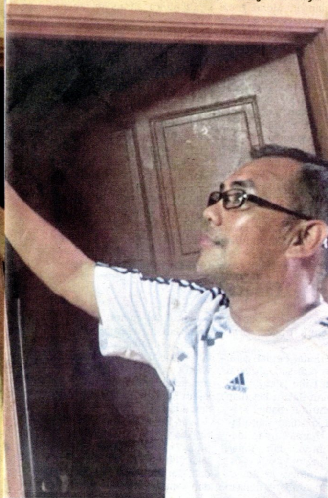
KHIRUDIN menunjukkan kesan retak di sebahagian rumahnya.
