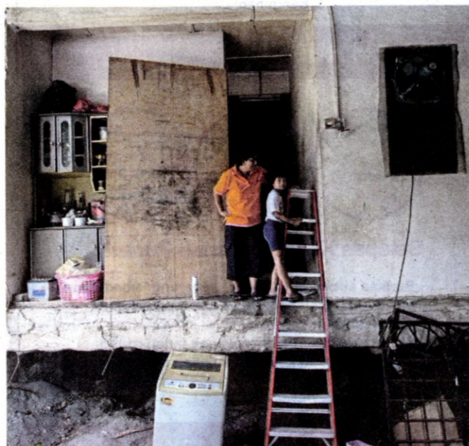
KEADAAN rumah yang terjejas akibat tebing Sungai Rawang yang runtuh di Taman Bersatu, Rawang.
