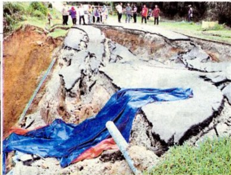
Kejadian tanah runtuh di jalan pintas utama di Felda Penggeli Timur, Kota Tinggi, akibat hujan lebat menimbulkan kesulitan kepada lebih 5,000 penduduk di kawasan sekitar.
