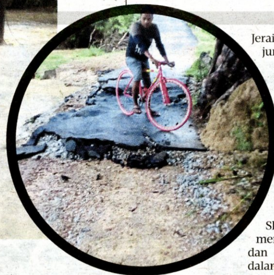
PENDUDUK melihat jalan kampung rosak selepas air surut.
