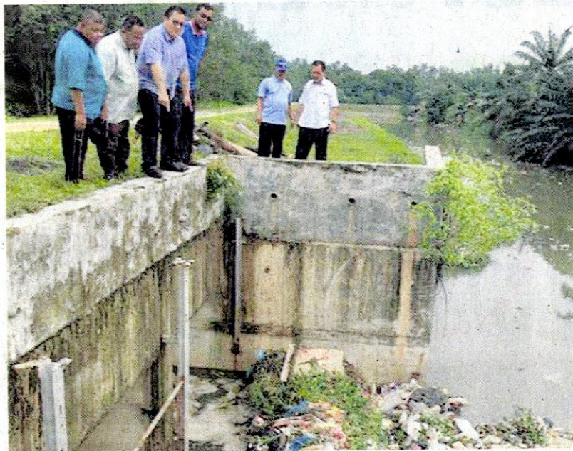
NUR JAZLAN MOHAMED (tiga dari kiri) meninjau keadaan pintu air Pengkalan Rinting, Johor Bahru yang dipenuhi sampah-sarap di Johor Bahru, kelmarin.
